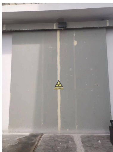
图 4-4 工件进出防护门 2
