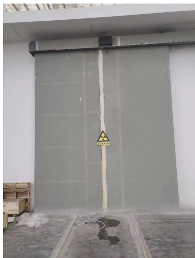
图 4-3 工件进出防护门 1
