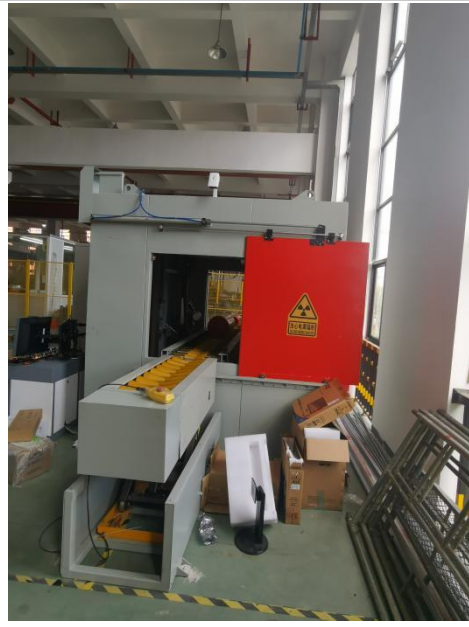
X 光检测室东面（进出工件铅门）
